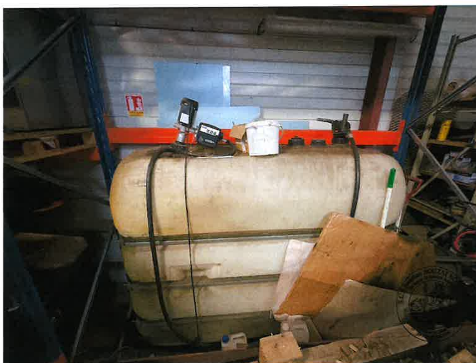
9. Cuve a fioul 2000L + pompe
